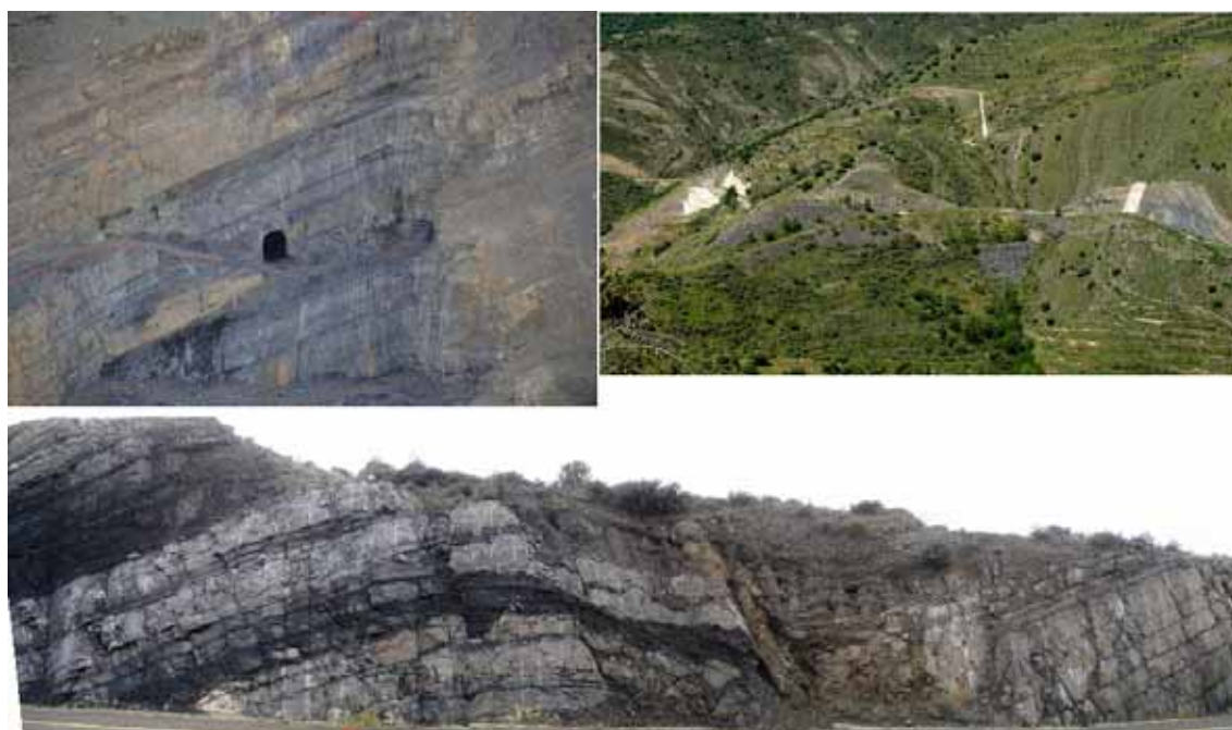
Fig. 3. a. Grietas en la zona de la cerrada del embalse de Enciso (a la izquierda de la galería). b. Deslizamientos en el vaso, algunos de ellos favoreciendo problemas en la carretera nueva. c. Falla afectando a los estratos situados por encima de la presa.
