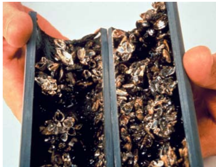
CORTE TRASVERSAL DE UNA TUBERÍA TAPONADA POR EL MEJILLÓN CEBRA. FOTO: DON SCHLOESSER GLSC
